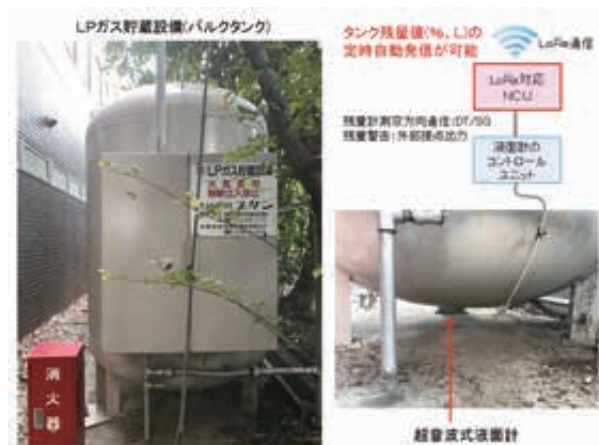
写真6 LPガスバルクタンクに液面計を装着
