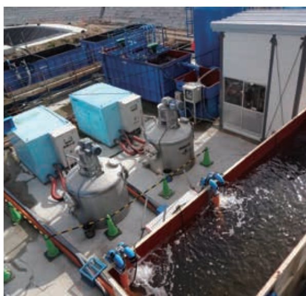
砂ろ過システムによる水処理の様子 提供：喜多機械産業株式会社
