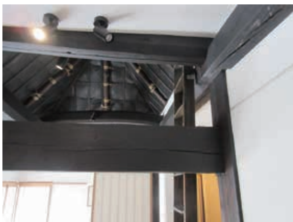
写真1 築約120年住宅リフォーム済の梁
